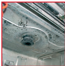
カルシウムスケールが多量に付着した洗浄槽内
