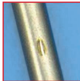
接触腐食： ステンレス鋼とステンレス鋼
