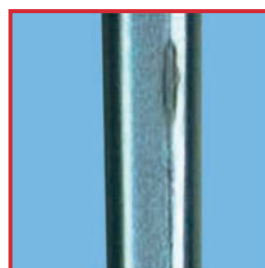
接触腐食：ステンレス鋼 と真鍮
